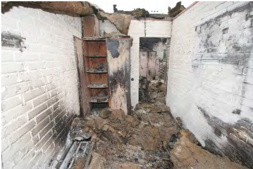
Bild 3. Visar lärarrummet, i borte delen det plåtskåp i vilket brand troligen anlades.
