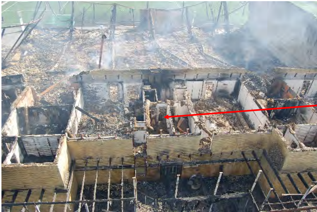
Bild 1. Visar vy över de brandskadade lokalerna, pilen visar på aktuellt lärarrum där branden startade.
