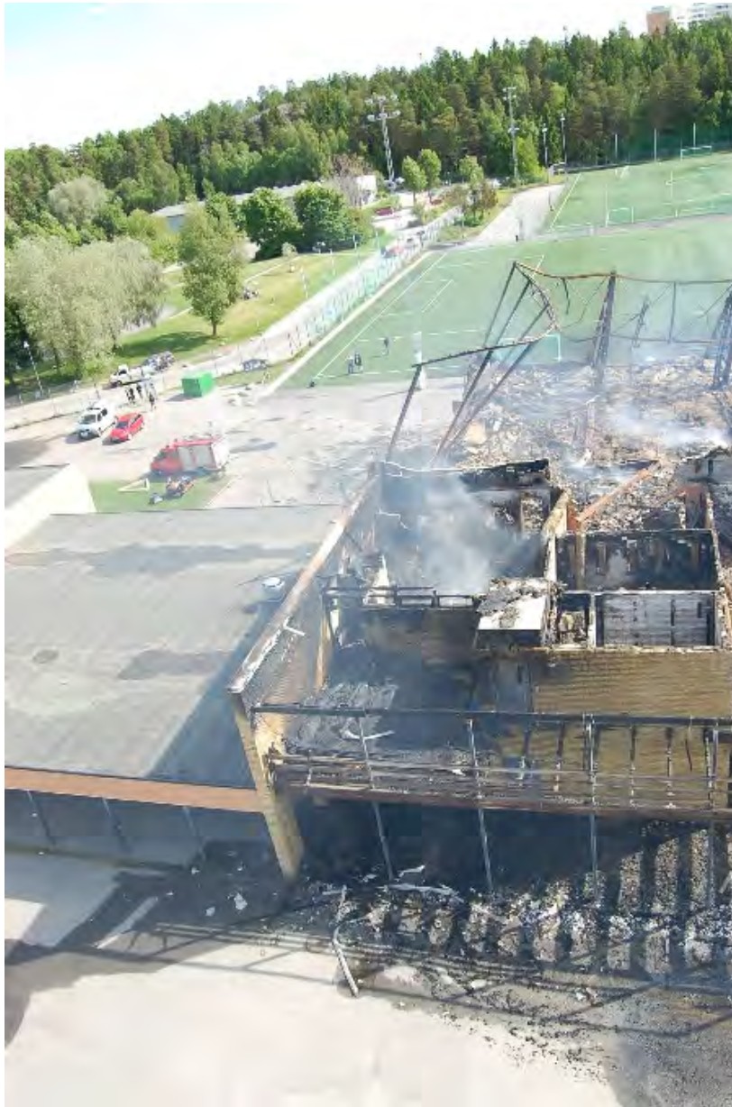
Bild 2. Visar på den brandskadade delen och brandväggen som skyddat cafeteria-delen.
