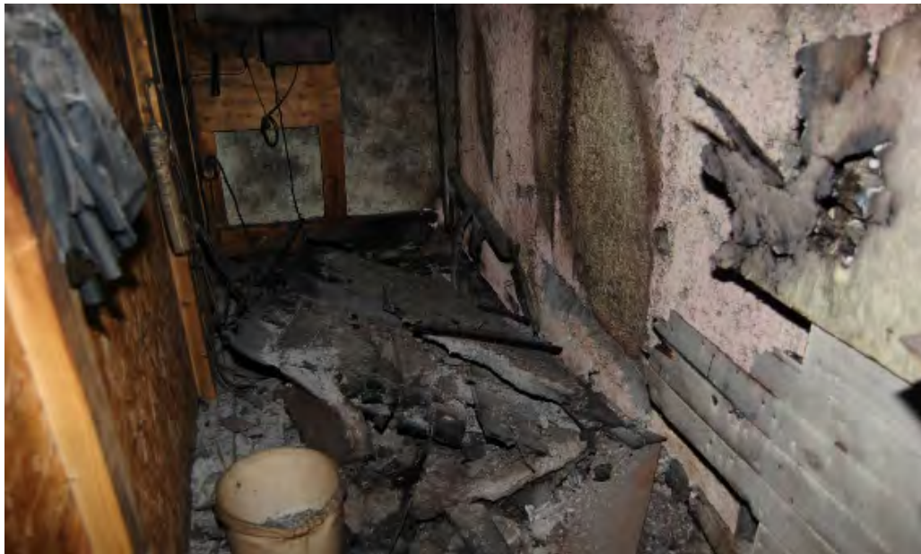
Bild 6. Visar rester av en brandhård bakom skjutbanas blinding.
