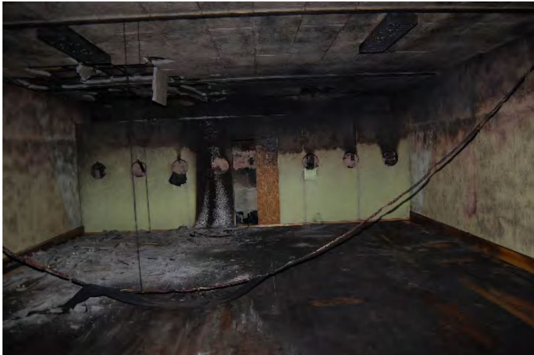
Bild 5. Visar inifrån skyttelokalen. Tre brandhärddar har noterats i denna lokal. Troligen anlagda. Brandcellsgränser och ventilationsöppningar har kontrollerats och det har ej gått att finna några brister som kan ha bidragit till brandspridning in till denna lokal.
