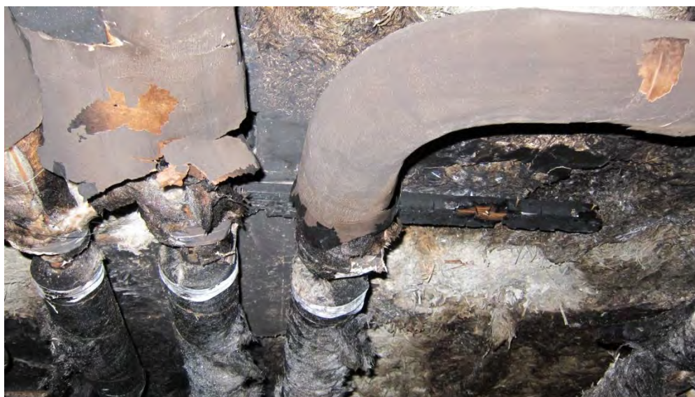
Vattenrören i taken var brandskadade. På bilden ses även resterna av träullsplattorna..
