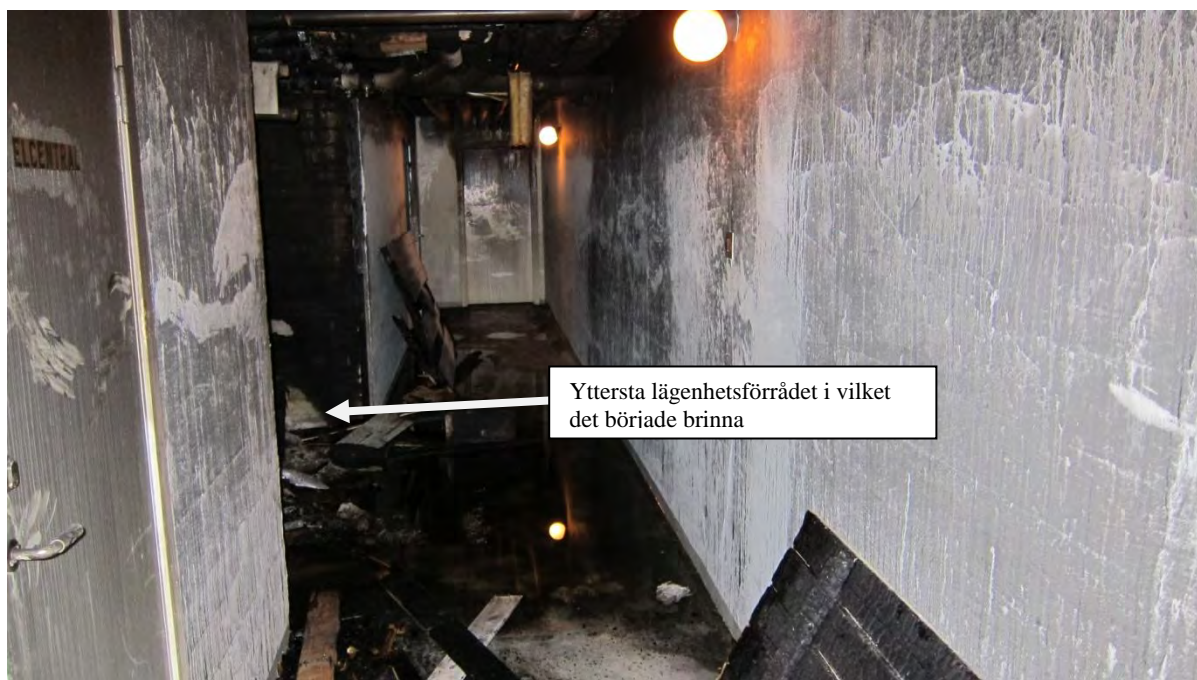
Källarkorridoren med primärbrandplatsen till vänster.
