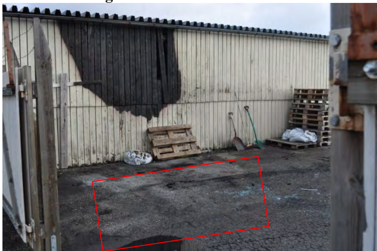
Fordonets placering med brandskadad vägg
