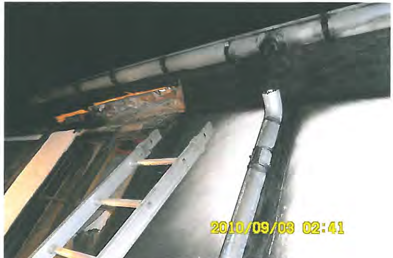
Foto 4 taget av räddningstjänsten på platsen och delar av byggnadens gatusida uppvisar tydliga brandskador.
