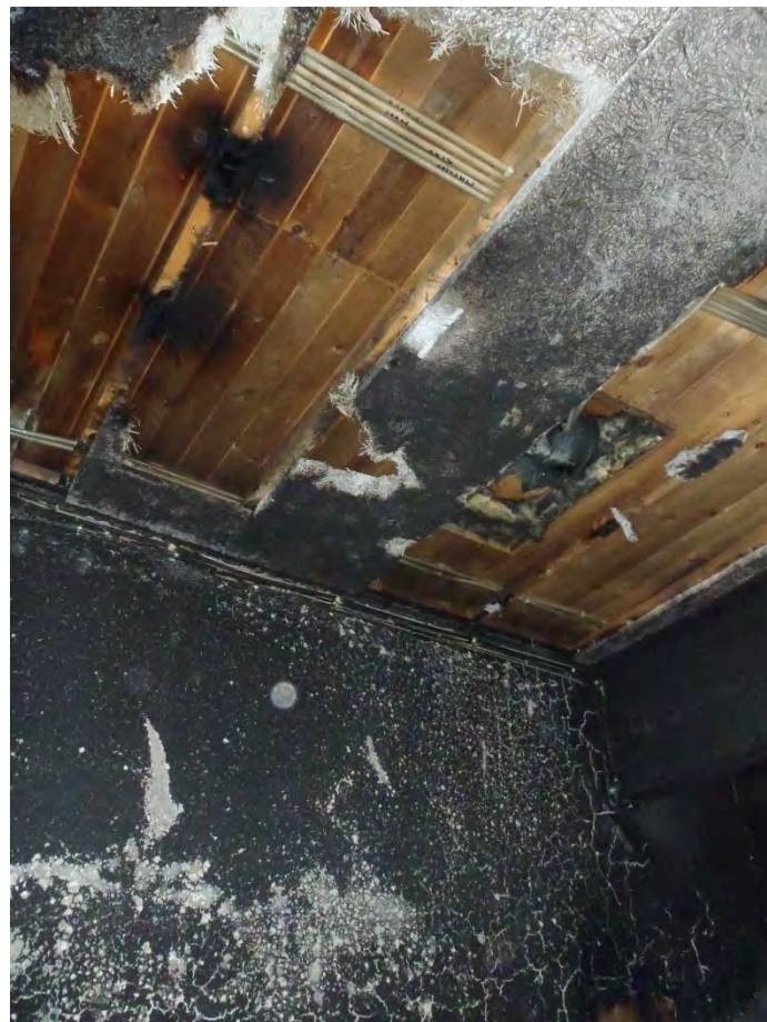
Bild 4. Utanför i taket i korridoren.
