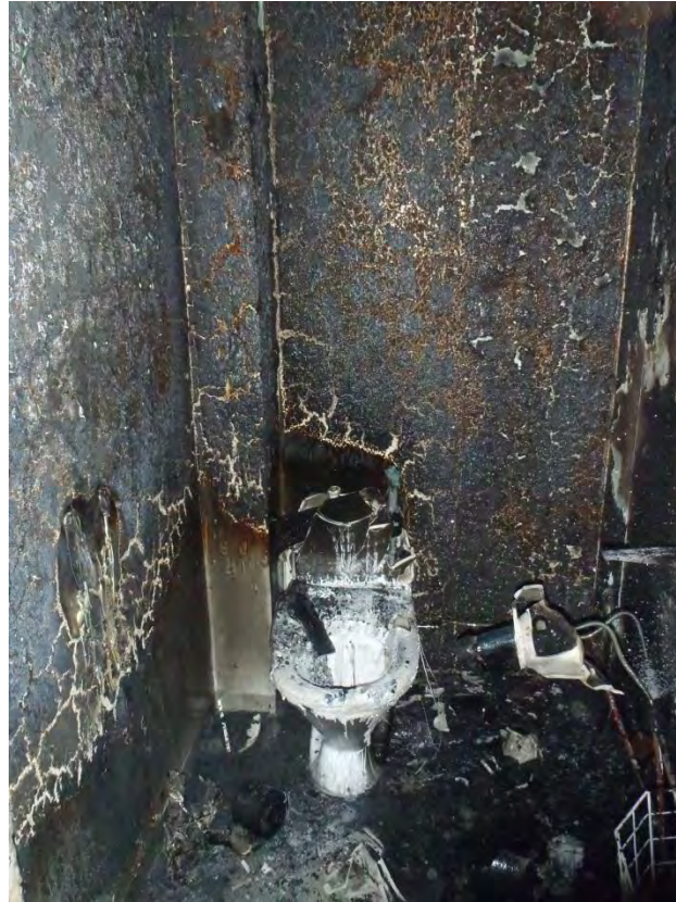
Bild 3. Här startade branden. Kraftigt bränd väggmatta och golv.
