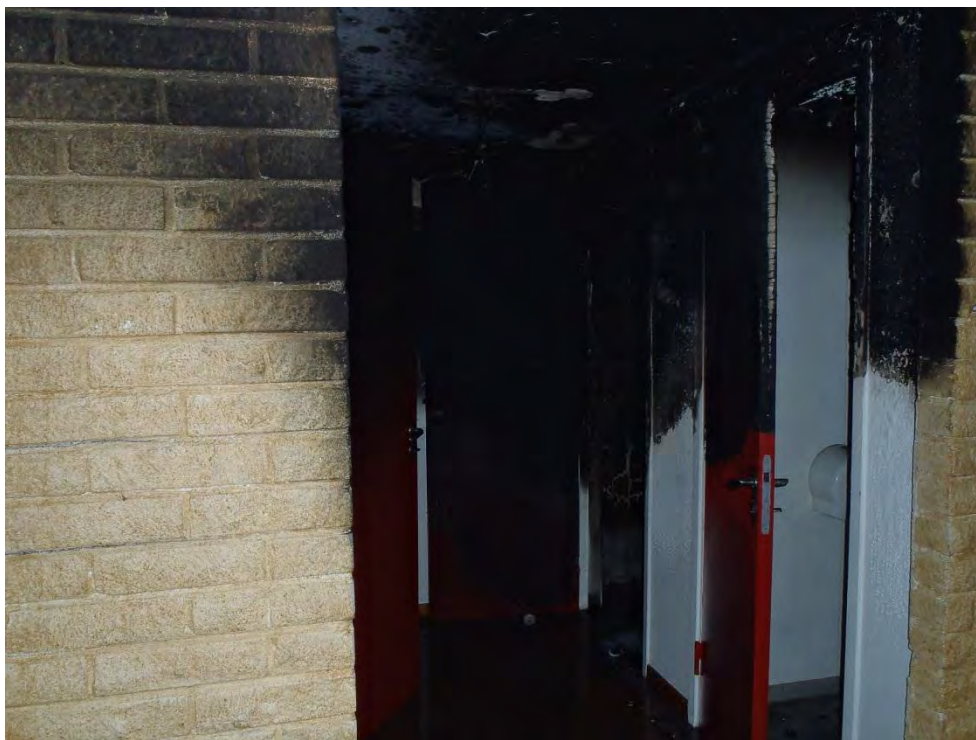
Bild 2. Direkt utanför de fyra toaletterna. Branden startade längst in till höger.
