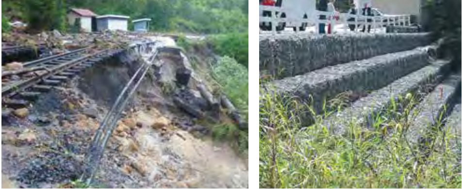
En järnvägsbank i Lockyer Valley spolades bort och har nu återuppbyggt och järnvägsbanken stabiliserats med stengabioner. Källa: Regional Council, Grantham. Foto till höger: Josefin Gullstrand, MSB.
