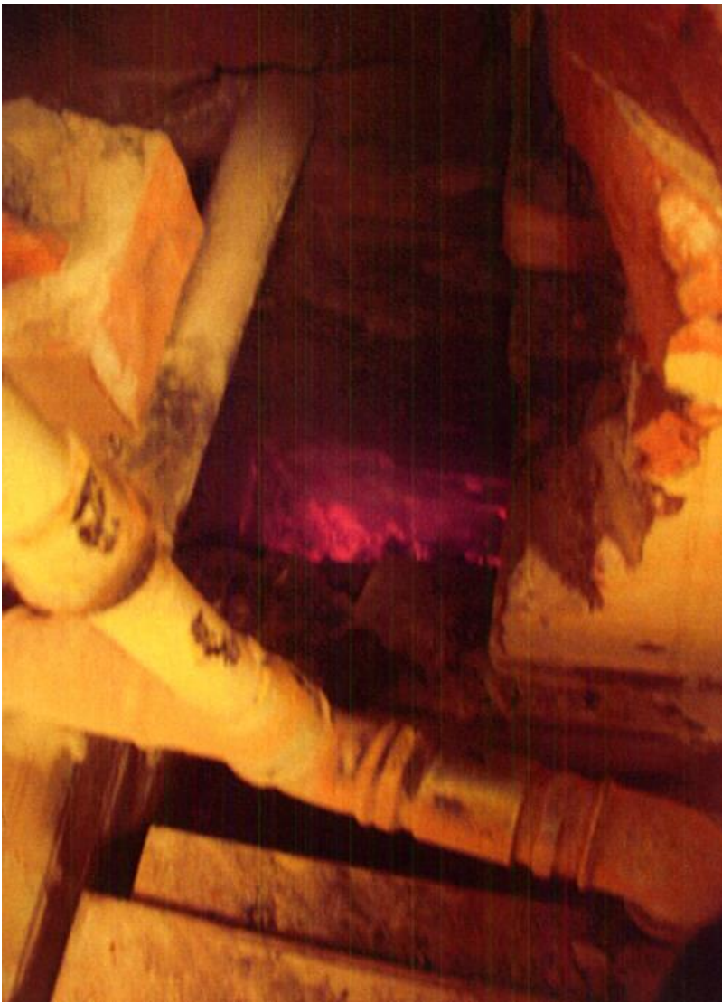
Håltagning samt rör genomföring genom röckanal. Glödande slagg i botten av skorstenen.
