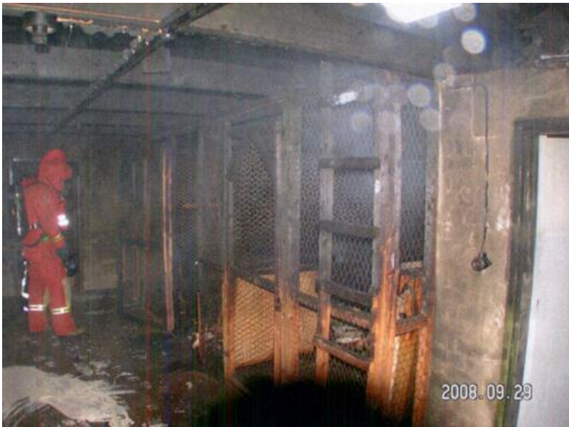
Vindsutrymmet mot det brandskadade utrymmet
