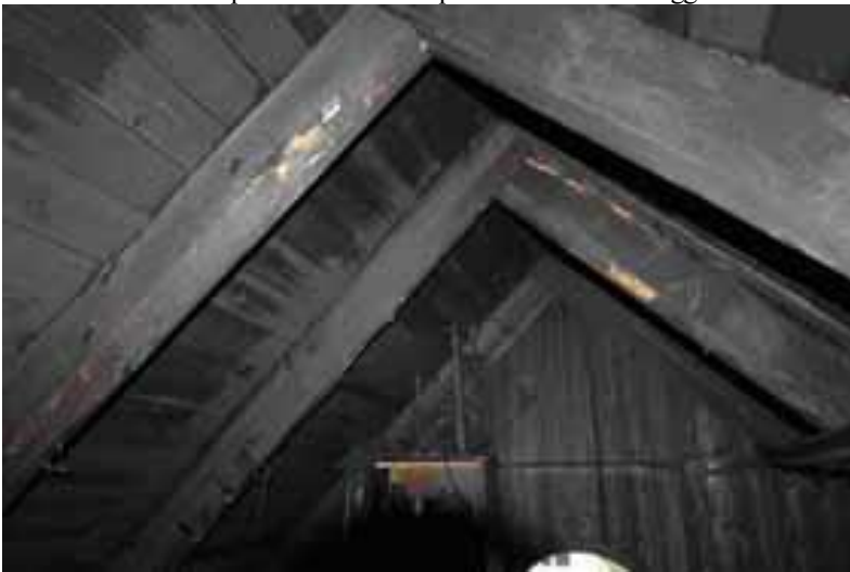
Kraftiga kolningsskador på takstolar och takpanel.
