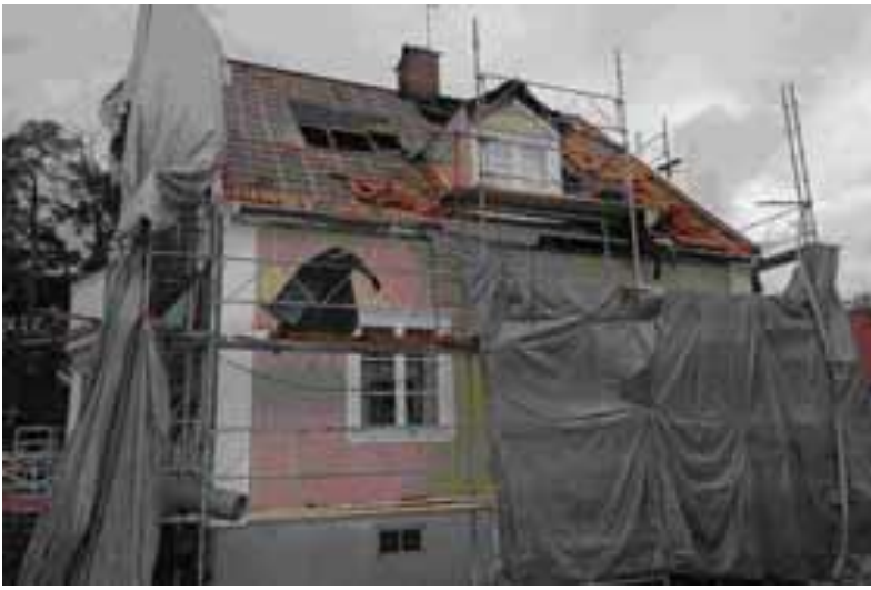
Arbete med varmluftspistol runt fönstret på vinden antände väggen och taket.
