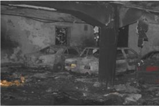
Brandskador på bilar i garaget. Branden har troligen startat i bilen längst till vänster på bilden. På bilden kan brand-v ses på väggarna som pekar i riktning mot bilens front. Pilen på bilden visar Utgång A .
