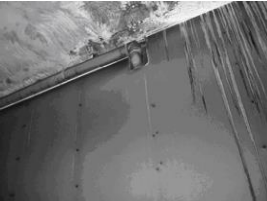
Otät rörgenomförning mellan garage och trapphus vid utgång B.
