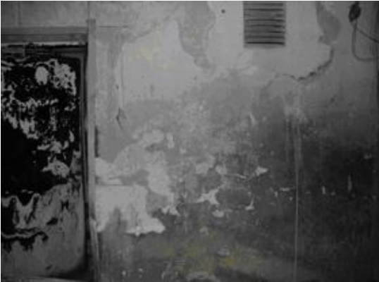
Dörren till utgång A kan ses i bildens vänstra kant. Pilen visar öppningen till den isolerade ventilationskanalen som går via ett förråd i källaren.
