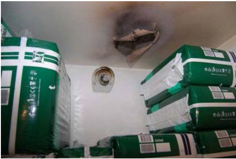
Bild 3 och 4. Visar hyllan i förrådsutrymmet, med brandskada i takskiva( gips).
