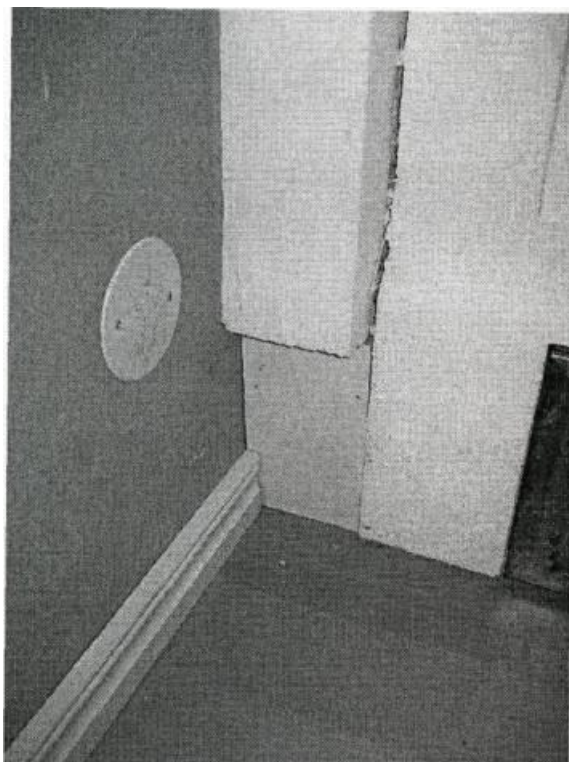
Foto 3 (och 4). Visar den igensatta luftspalten på bägge sidor av kakelugnen.
