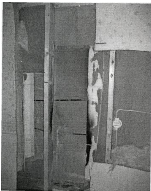
Foto 2. Visar baksidan av kakelugnen. Bränt regelverk, den brända boardskivan är utslängd.
