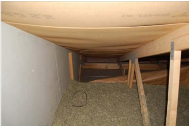
Den lägenhetsavskiljande väggen på vinden går upp till takboarden vilket inte ger ett tillräckligt bra skydd mot brandspridning till angränsande lägenheter. Glespanelen från balkongtaket syns längst nere vid takfoten. Takstolarna som förlorade sin bärförmåga i ett tidigt skede är sammanfogade med spikplåtar.
