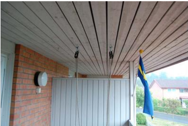
Glespanelen i taket på balkongen ansluter direkt till vinden (se bilden ovan).
