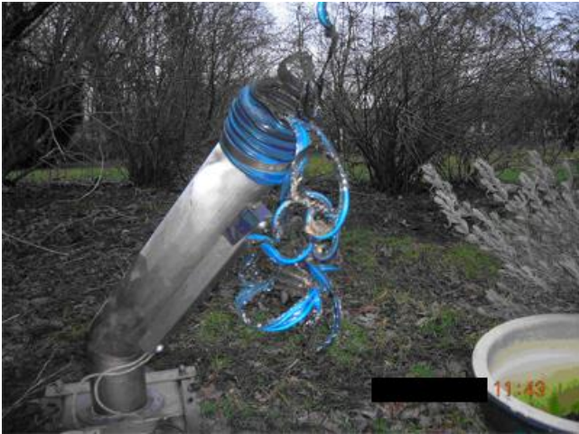
Plaströr brunnit av, observera tejen på bakbrandspärren.
