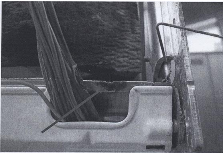
Bild 2. Svetsskada på plåtkanten vilket markeras med en röd pil i bilden.
