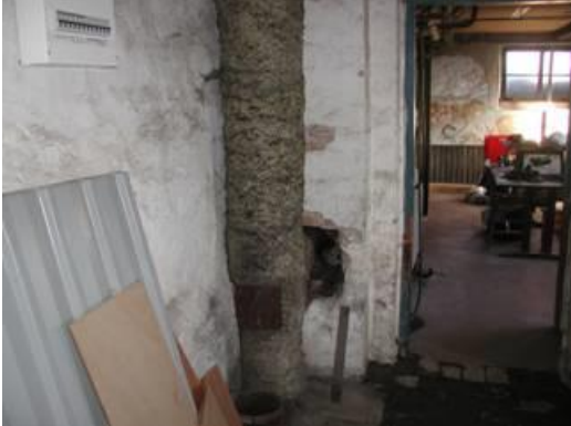
Den aktuella rökkanalen. Schakt saknas i källaren.
