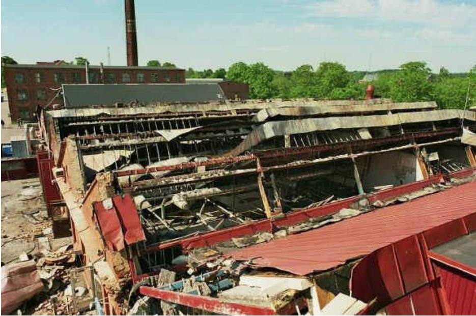
Bilden är en vy över taket. Där syns var brytning av taket gjordes, en sträcka på ca 50 m. Totala ytan är ca 3000 kvm.
