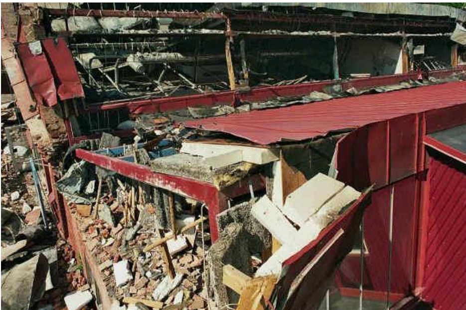
Här kan vi se delar av takkonstruktion som gjorde brandspridningen snabb. Plåt, tjärpapp, 12 mm plywood, 15 cm frigolit, ca 20 cm cementbunden träspån.
