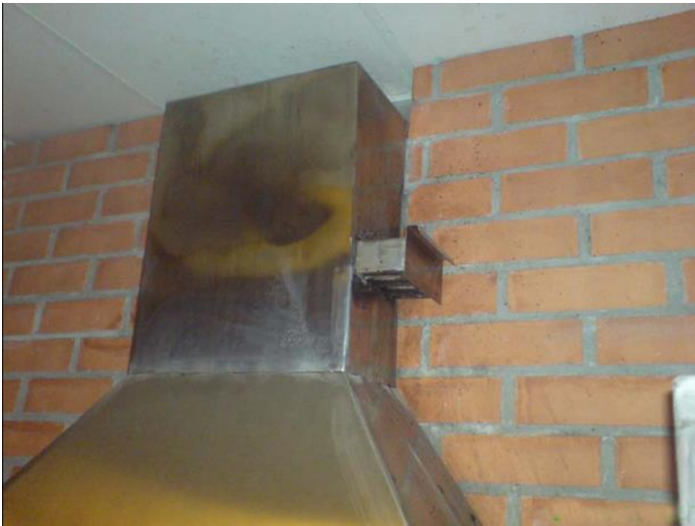
bilden visar ventilationskanalen från kolgrillen. På bilden syns även filtret som är delvis utdraget. På ventilationskanalen syns tydligt att det varit höga temperaturer runt filtret.
