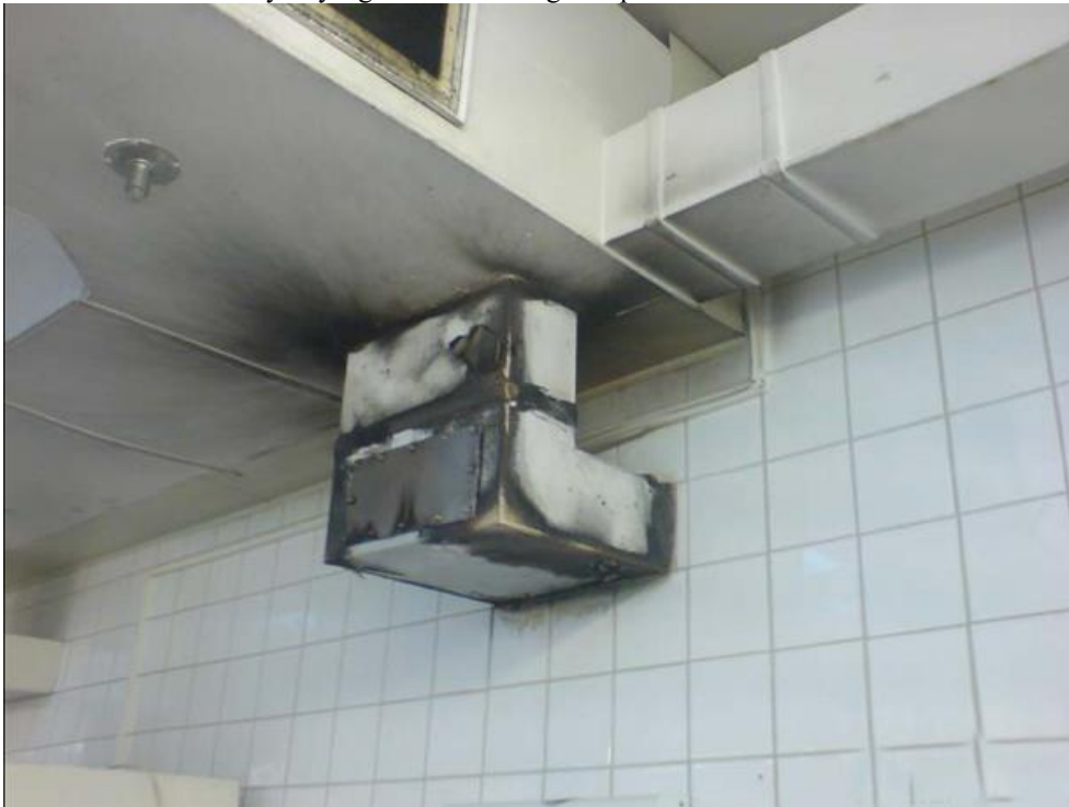
Bilden visar ventilationskanalen på andra sidan väggen. Det syns tydligt att denna del av ventilationskanalen har varit utsatt för höga temperaturer.
