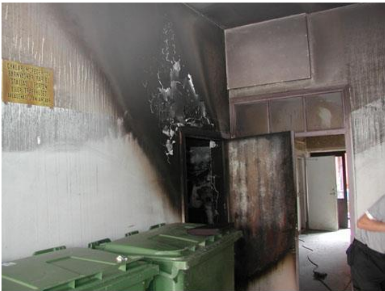
Dörren till brandrummet som stått öppen samt det borttagna dörrpartiet till nästa trappa. Soperummen placerades utomhus direkt efter upptäckt.
