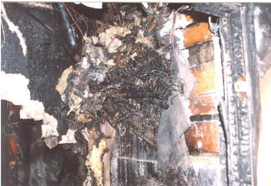
El-centralen på väggen i städskrubben.
