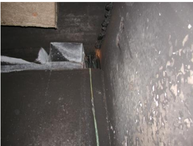
Kabelgenomföringen, ca 20 x 30 cm, mellan trapphus och restaurang saknade brandtätning.
