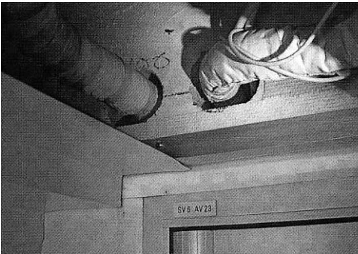
Bilden är tagen i korridoren utanför skyddsrummet mot trapphus 23. Bilden visar bristande tätning i brandcellsgräns.
