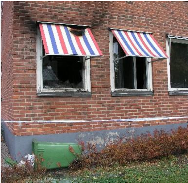
De fyra fönstren som tillhör det brandhärjade kontorsrummet. Fönstret till vänster var krossat innan branden startat vilket kan ses på att glaset på marken är osotat. Soptunnan har använts som fotstöd.
