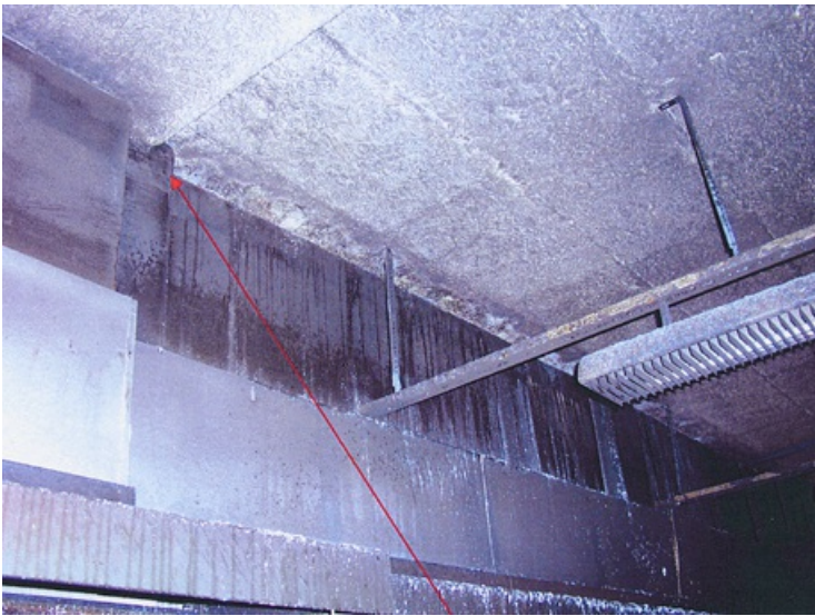
Affärslokalens övergång mellan tak och vägg där spridning kunde möjliggöras till fasad på grund av att det fanns ett mellanrum i sektionerna. Detta mellanrum täcktes endast av isolerskivor bestående av träull.
