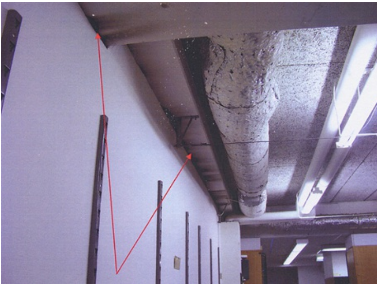
Rökspridningen till systembolagets lokal. Konstruktionen var densamma som vid ytterväggen.
