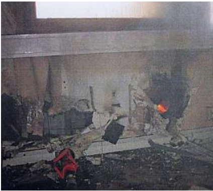
Brandspridning i väggarna.
