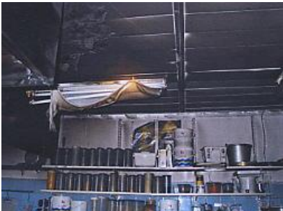
Lågorna antände även belysningsarmatur i taket.
