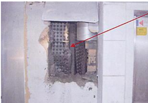
Ventilationsschakt från köket. Lägg märke till isoleringsmattorna av plast.
