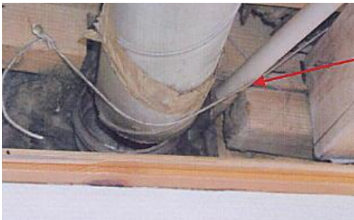
Ventilationskanal i en av lägenheterna. Tejp och snöre talar för sig själv.
