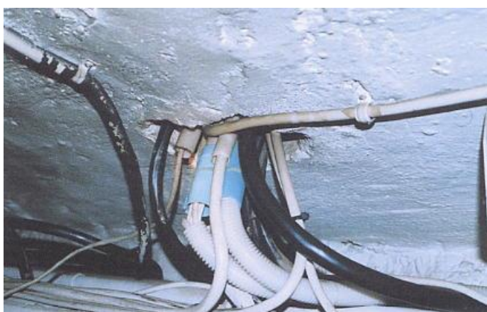
Ingen brandtätning i kabelgenomföringarna.
