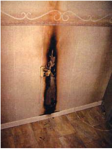
Brand- och värmeskador i vardagsrummet i lägenheten ovanför.
