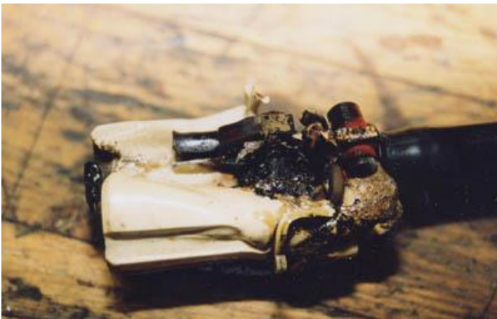
Honkontakten efter demontering. Kolbrygga mellan fas och skydds- jord tillåter elektrisk överledning utan att säkringen löser ut.
