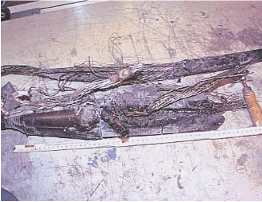
Öppnad kabelbox, kulningar på kabel.
