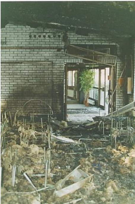
Den helt utbrända café- och konferenslokalen med glasdörrarna mot entrén där brandspridning kunde stoppas.
