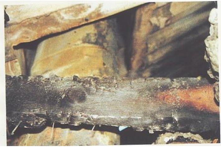
Träbjälkarna antändes av rökröret. Schakt saknades på vinden. Utförandet överensstämde ej med byggbestämmelserna.
