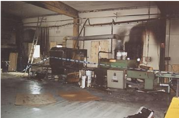
Den brunna ytbehandlingsmaskinen vid undersökningstillfället. Sprutmålningsdelen vid pilen har de lägsta och svåraste brännskadorna men branden har varit omfattande hela vägen mellan maskinen och ytterväggen.
