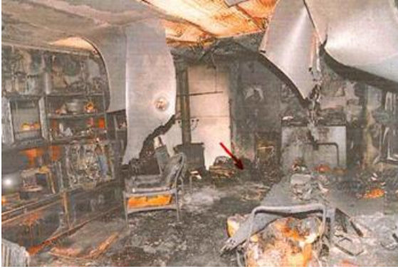
Södra delen av vardagsrummet, brandhård vid pilen.
