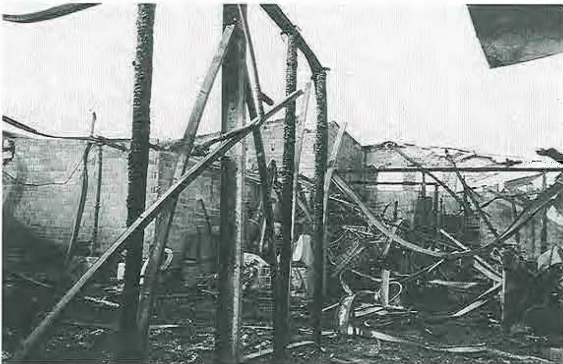
Fig. 4: Byggnaden är totalskadad
