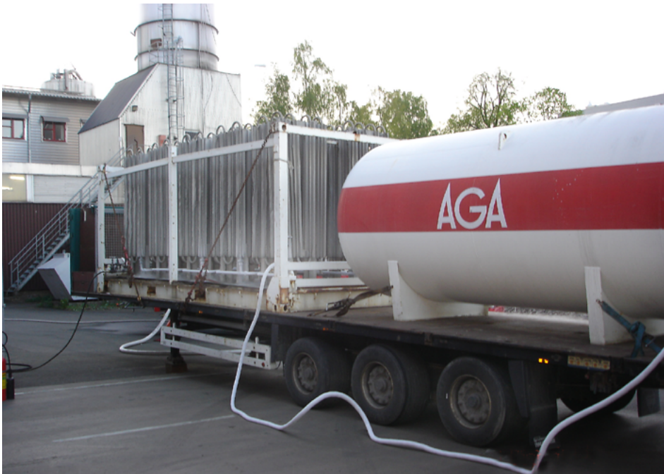
Kvävgastank med förångare på ett trailersläp ställdes upp vid silon.
