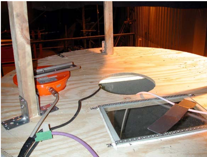
Figur 8 MGD-detektorn (orange) monterad genom taket på silotoppen.
