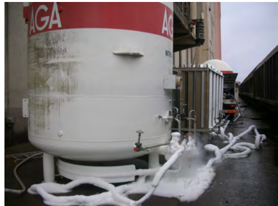
Figur 3 – Kvävgasinstallation för inertering
