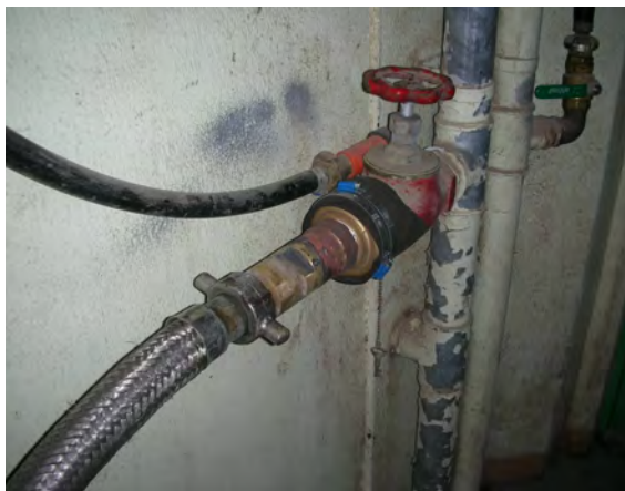
Figur 4 – Anslutning till stigarledning. Användes för inertering/toppfyllning i väntan på lansarna.
