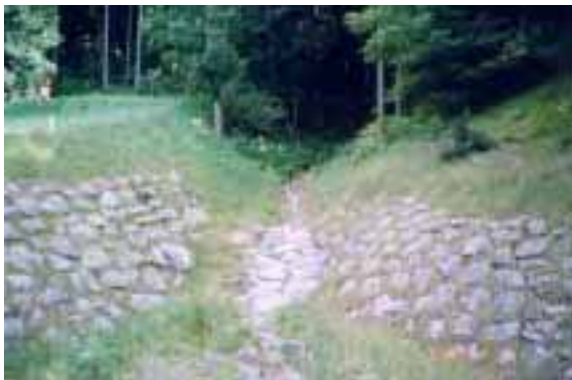
Figur 39 Tillflödet till en sedimentationsdamm med stensatta jordvallar, Rettenbach, Schwaz. Foto: J. Fallsvik, SGI.
