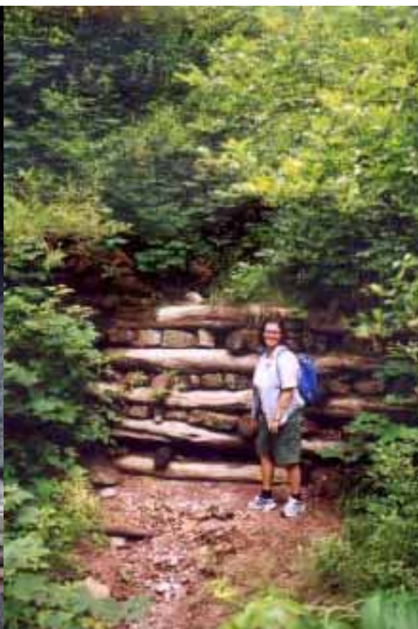
Figur 22 Exempel på erosionstrappa konstruerad som en stenkista. Rettenbach, Schwaz, Österrike. Foto: K. Rankka, SGI
