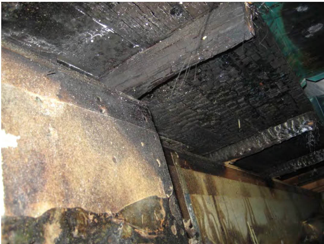
Brandskadad takdel och del av vägganslutning.
