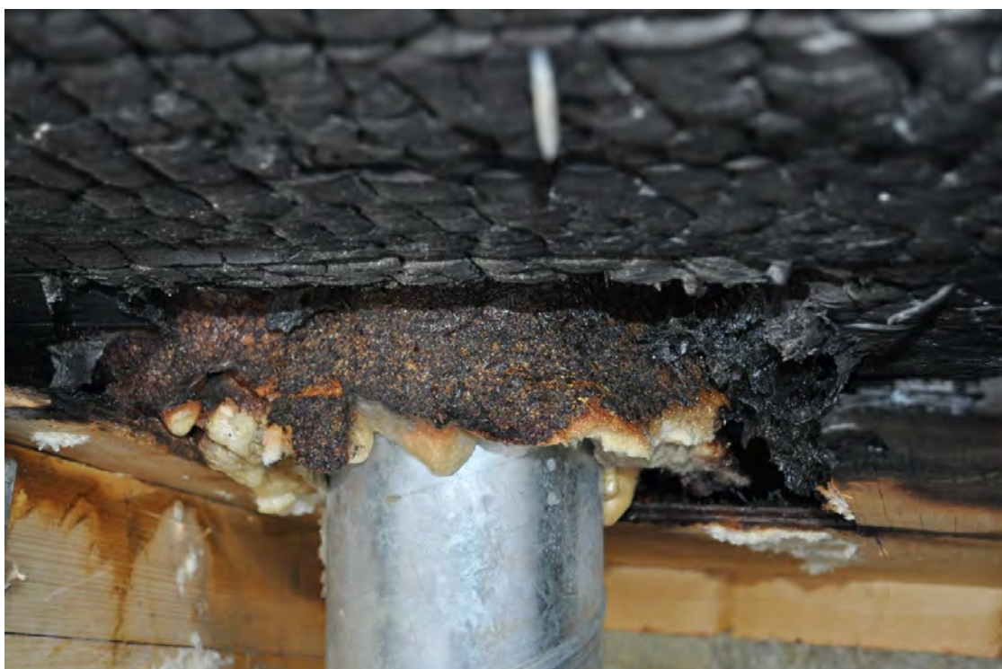
Fogskum som smält pga yttre värmepåverkan. Notera även brandskadorna i yttertakets undersida tillhörande en annan brandcell än startutrymmet.
