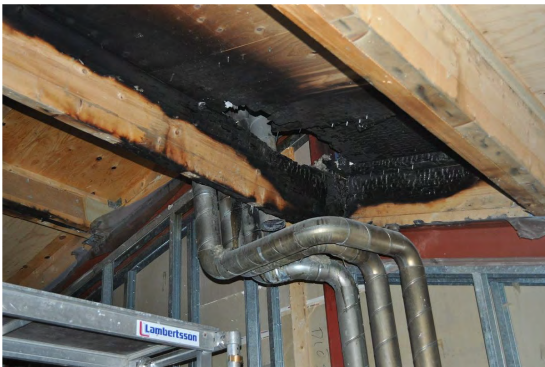
Brandskadad balk och brandskador i yttertak, vy mot sydväst.
