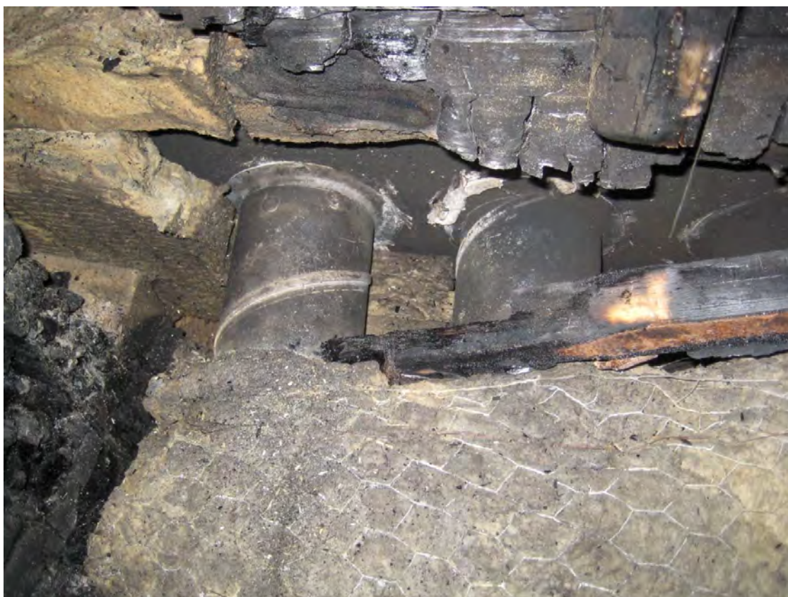
Kanalanslutning mot gemensam samlingskanal. I bildens överkant syns de oisolerade kanalerna och resterna efter råsponten som antänts.
