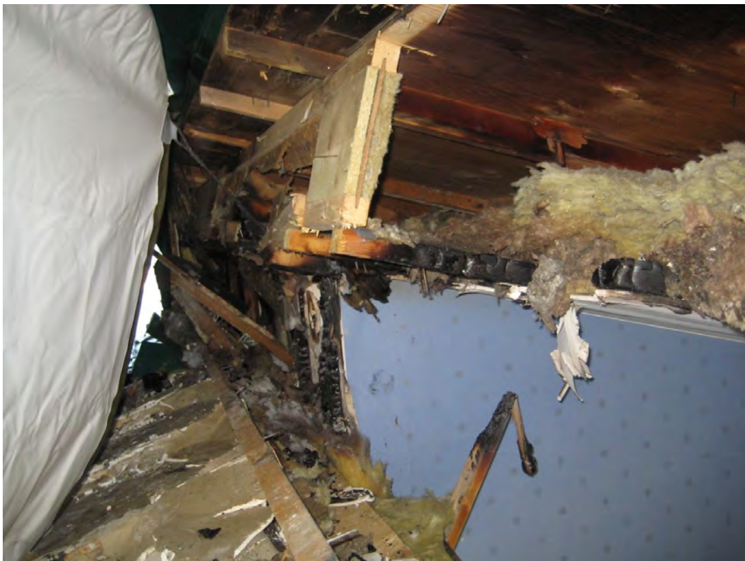
Bilden visar sektion av yttertaksstrukturen med lättbalk, typ H-balk, som utgör del av vägganslutning mellan de två taknivåerna.
