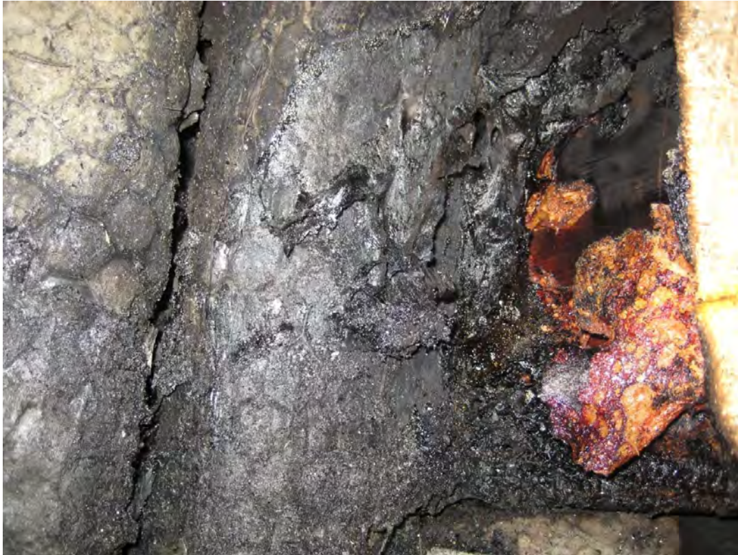
Till vänster i bild syns de isolerade kanalerna. Till höger i bild syns rester efter fogskum som smält.
