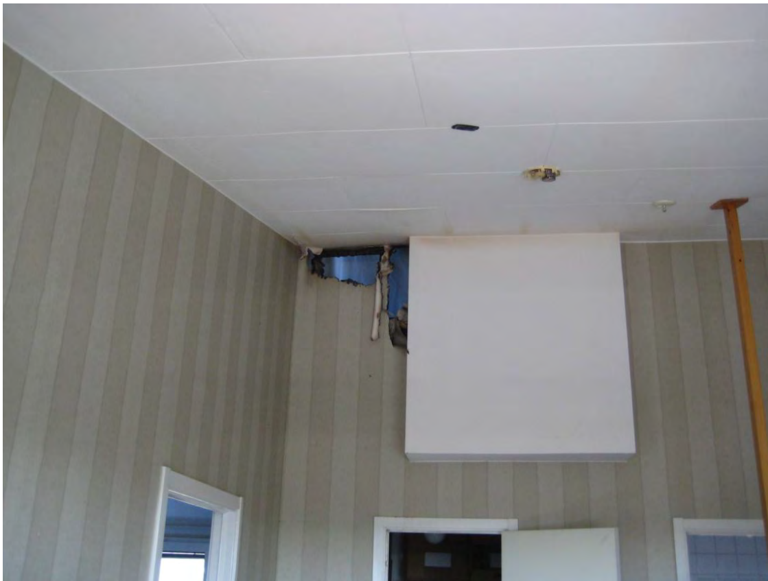
Bilden visar genombränning från utvändigt luftat utrymme, hall våning 4 tr.
