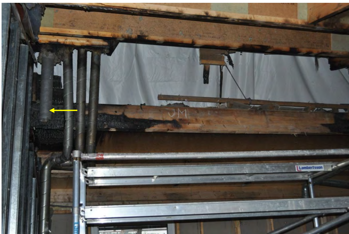
Brandskadad balk och frilagda ventilationskanaler, vy mot norr. Pilen visar den avkapade imkanalen.
