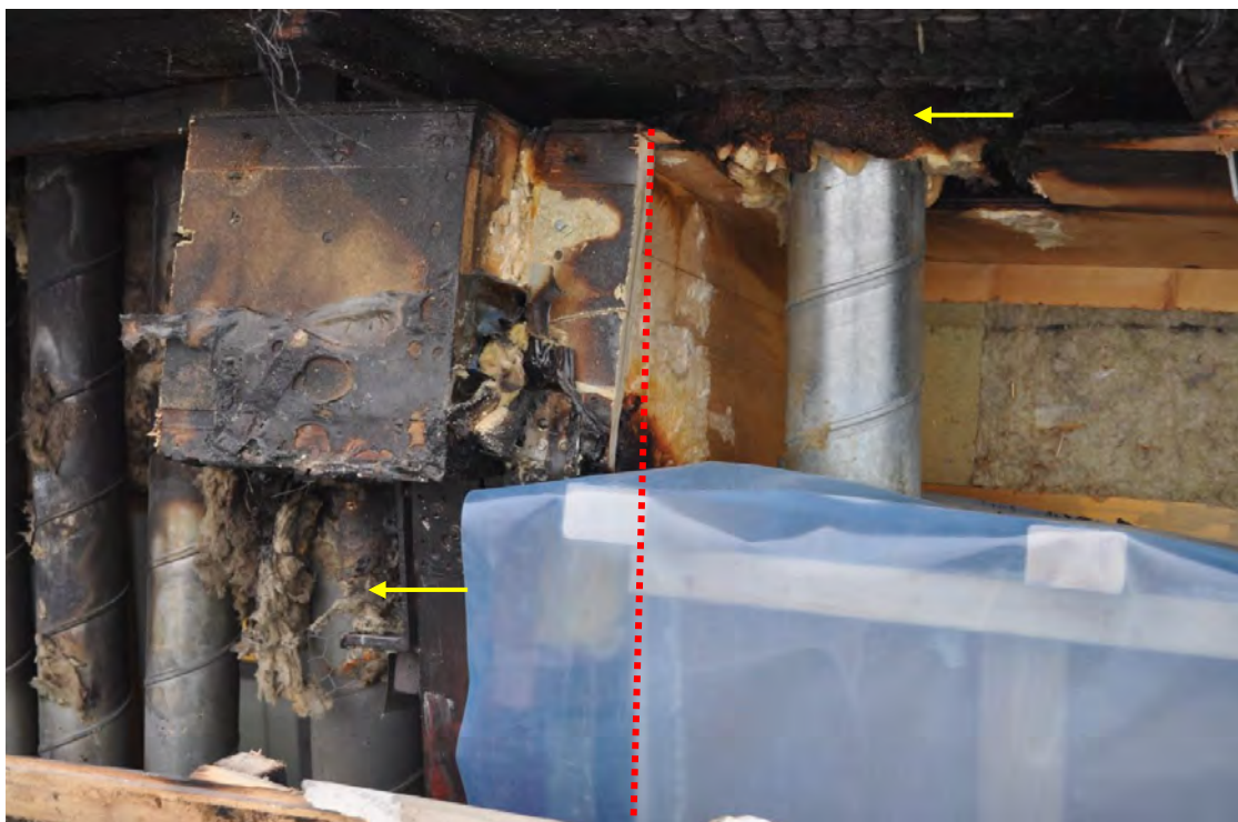
Pilen till vänster visar den brandpåverkade imkanalen. Till höger i bild syns imkanal från annan brandcell. Konstruktionen är delvis återställd (nya reglar, ny byggplast). Punktstreckad linje visar brandcellsgräns. Pilen till höger visar fogskum mot ickebrandpåverad imkanal i annan brandcell.
