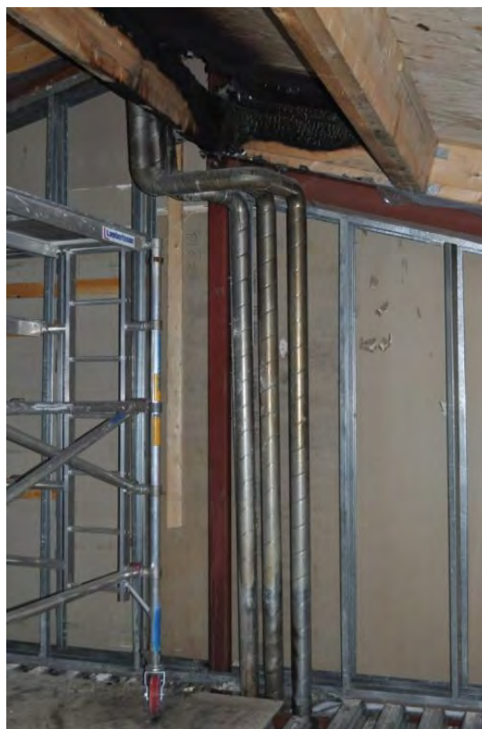
Frilagda kanaler efter rivningsarbete. Imkanalen har kapats och syns därför inte i bild.
