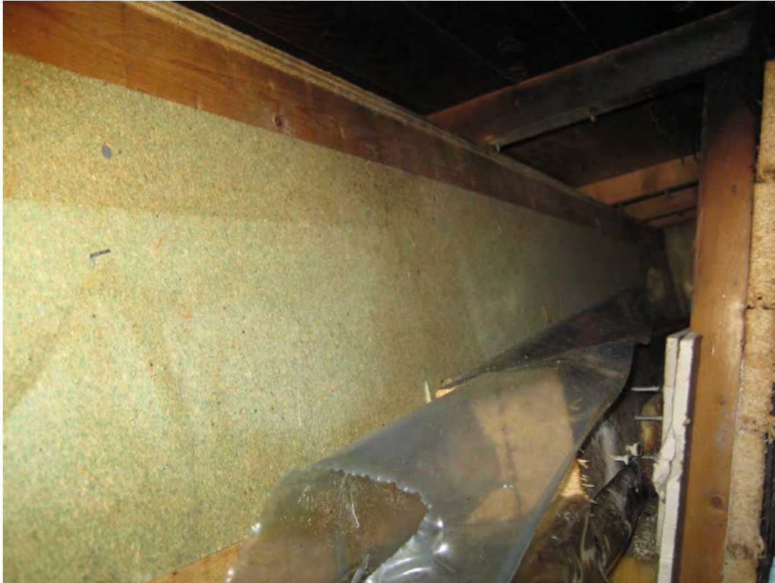
Bilden visar en oskadad del av vägganslutningen mellan de två taknivåerna. Notera det stora utrymmet mellan råsponten och beklädnadsskivan samt plastfolie på den "kalla sidan".
